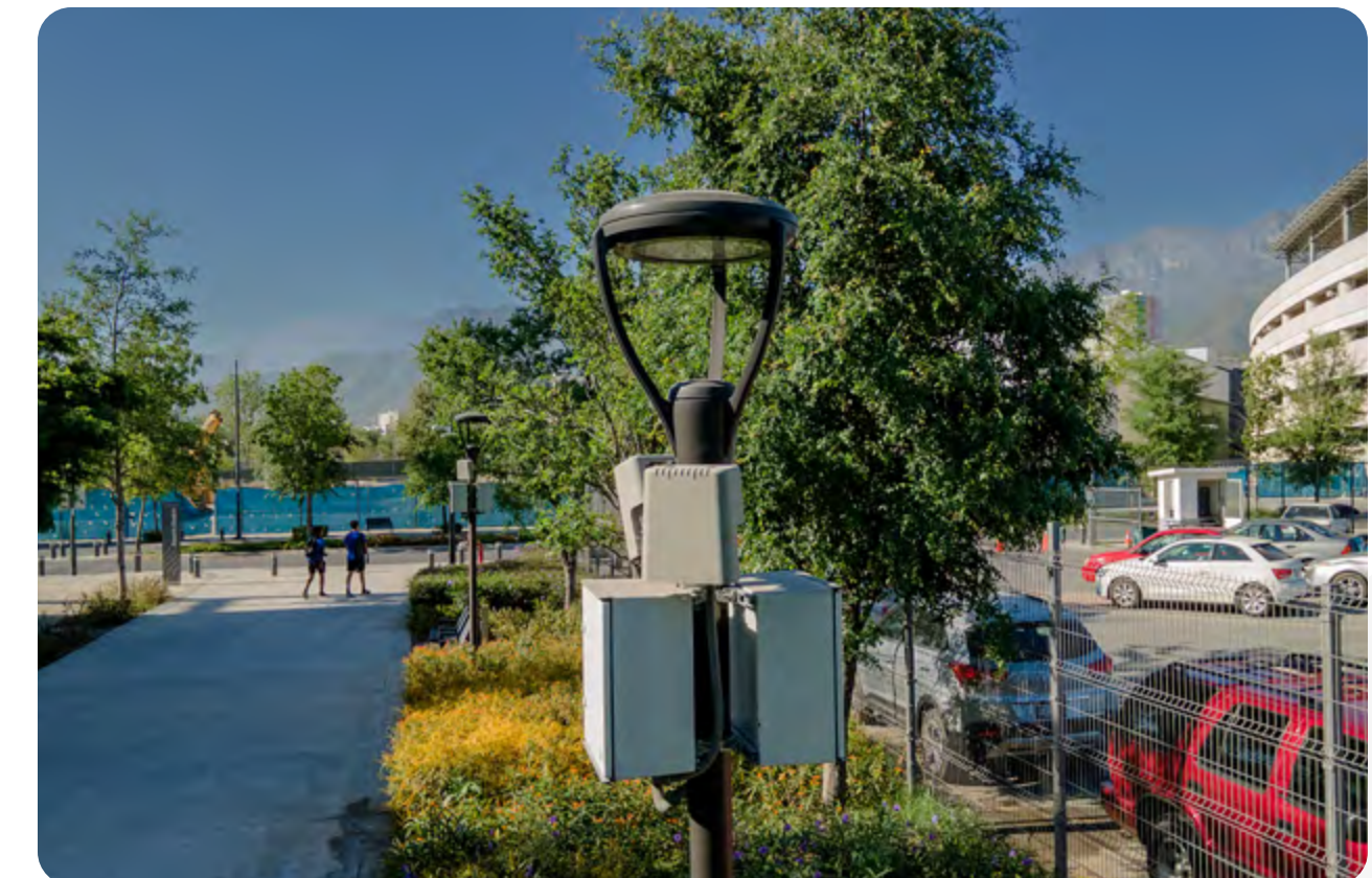
Fotoceldas en postes de luminarias, Parque central, campus Monterrey.
